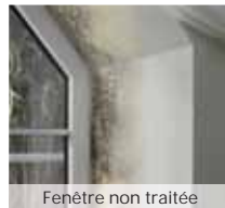
Fenêtre non traitée
